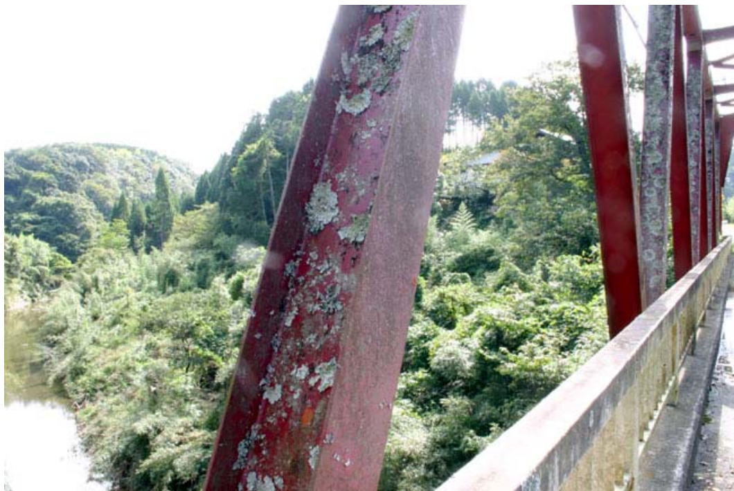
図 2. 橋げたの赤いペンキが白っぽい地衣類で覆われていた。小湊鉄道養老溪谷駅（千葉県市原市）から大福山に向かう途上の「ほうえいはし」。
